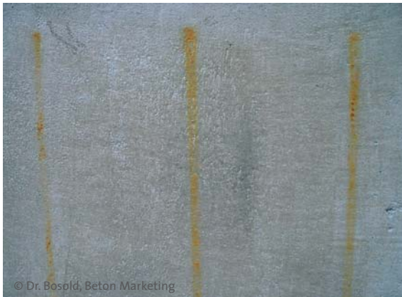
Abb. 15.5 Deutlich sichtbare Rostspuren
