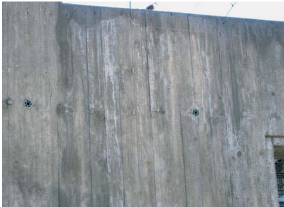
Abb. 12.10 Ausblühungen an einer Wand
