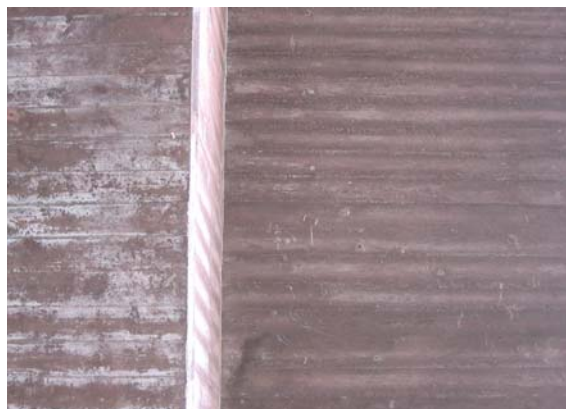
Abb. 12.12 Das bei trockener Witterung ausgeschaltete Seitenteil (rechts) zeigt keine Ausblühungen
