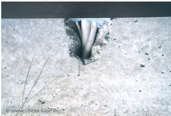
Abb. 15.17a Von einer Kabeldurchführung beschädigte Oberfläche
