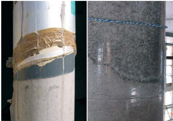
Abb. 14.16 Verfärbungen (rechts) wegen abgerissener Schalhaut (links)
