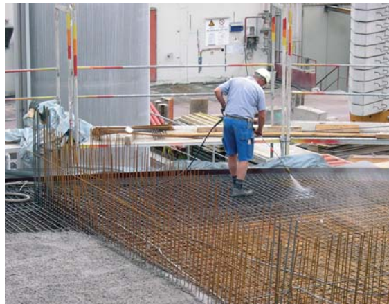
Abb. 9.6 Unmittelbar vor dem Betonieren sind lose Teile und Schmutz mit Hochdruck von der Schalung zu entfernen
