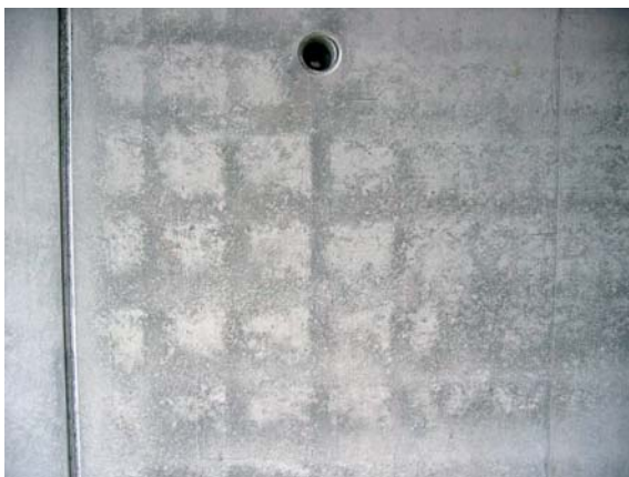
Abb. 14.17 Bewehrung zeichnet sich an der Oberfläche ab
