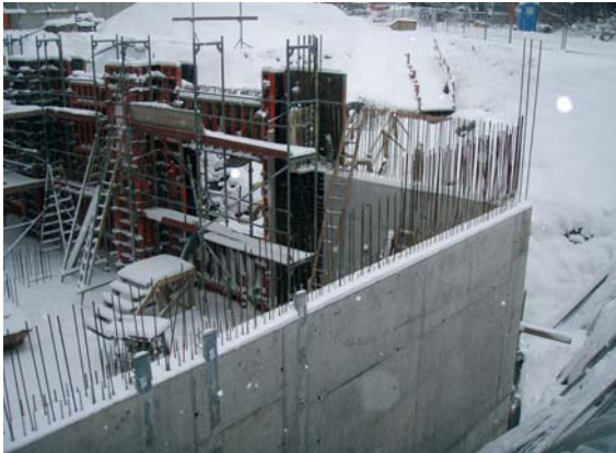
Abb. 12.6 Ungeschützte Anschlussbewehrung rostet bei Schnee und Regen
