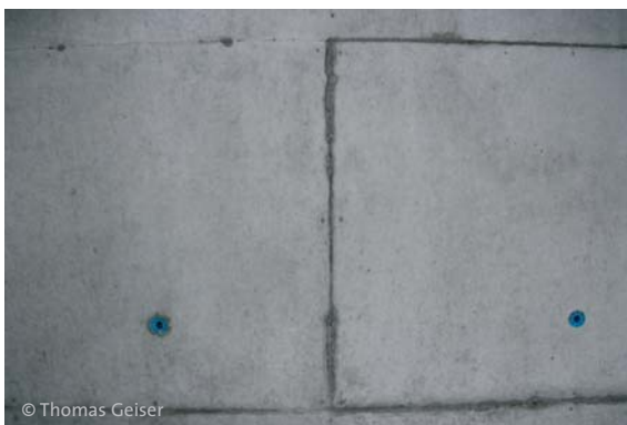
Abb. 15.18a Detail einer missglückten Wandfläche
