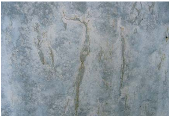
Abb. 5.5 Verfärbungen wegen Trennmittelüberdosierung
