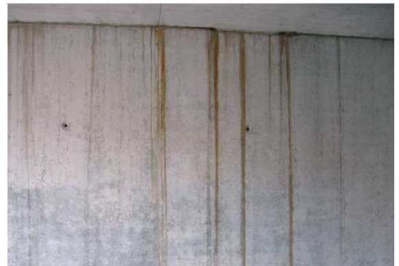
Abb. 14.6 Rostspuren von ungeschützter Anschlussbewehrung
