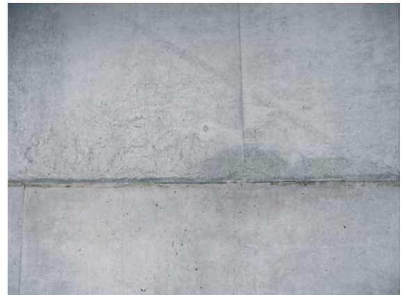
Abb. 14.20 Leichte Farbunterschiede und Ausblutungen an der Betonierfuge
