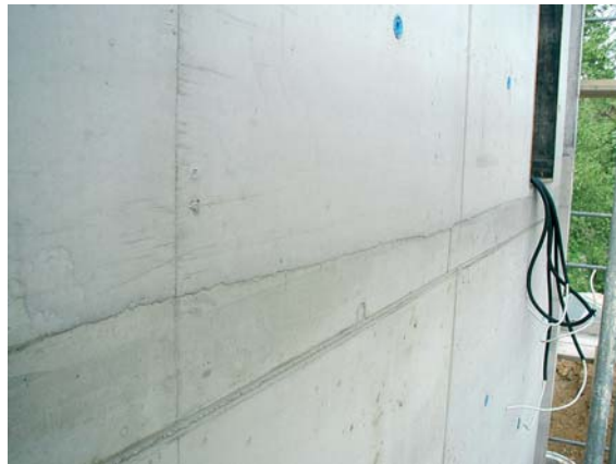
Abb. 6.12 Betonierfuge ohne Einlegen von Leisten
