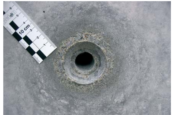
Abb. 14.14 Beim Spannanker ausgelaufener Zementleim
