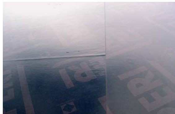
Abb. 4.7 Ripplings auf der Schalhaut
