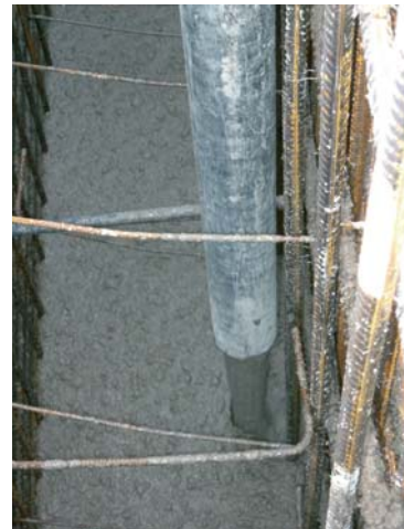
Abb. 6.17 Das Einführen des Schlauchs in die Schalung reduziert die Fallhöhe des Betons
