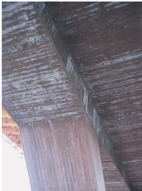
Abb. 12.11 Ausblühungen an einer Brückenunterseite
