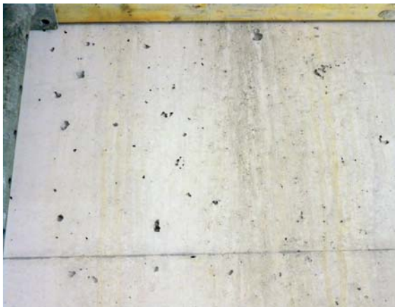
Abb. 9.10 Lunker und Poren im oberen Wandbereich
