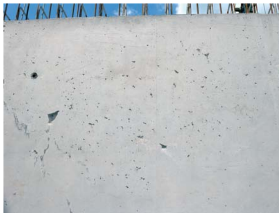
Abb. 14.19 Häufung von Lunkern im oberen Wandbereich
