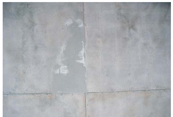
Abb. 15.8 Sichtbare Spachtelung an einer Deckenunterseite
