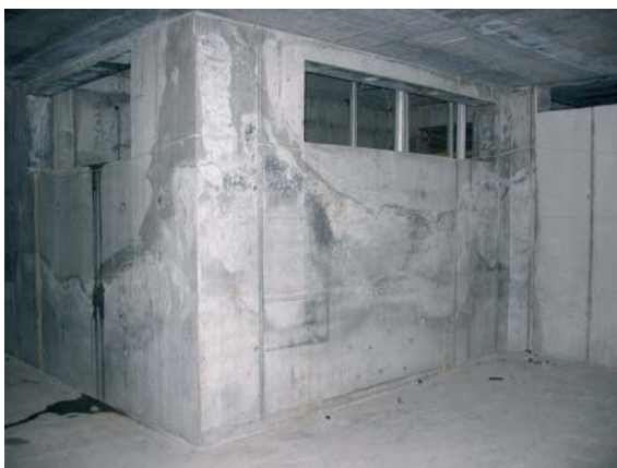
Abb. 11.2 Dunkle Verfärbungen, wo die Folie den Beton berührte
