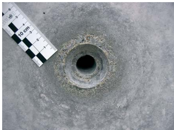
Abb. 6.21 Beim Schalungsanker ausgelaufener Zementleim
