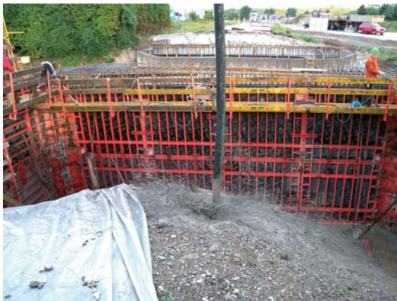
Abb. 9.8 Anpumpen von Beton außerhalb der Schalung
