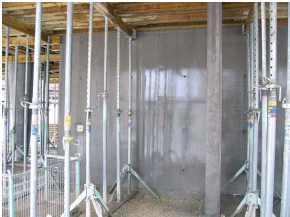
Abb. 14.1 Durch Abwaschen entfernte Betonnasen
