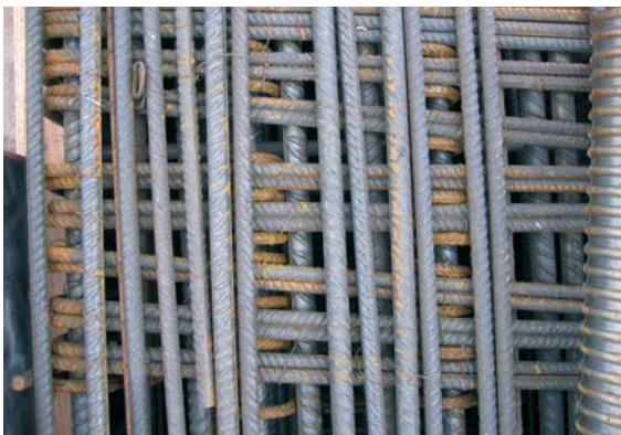
Abb. 9.2 Zu eng verlegte Bewehrung
