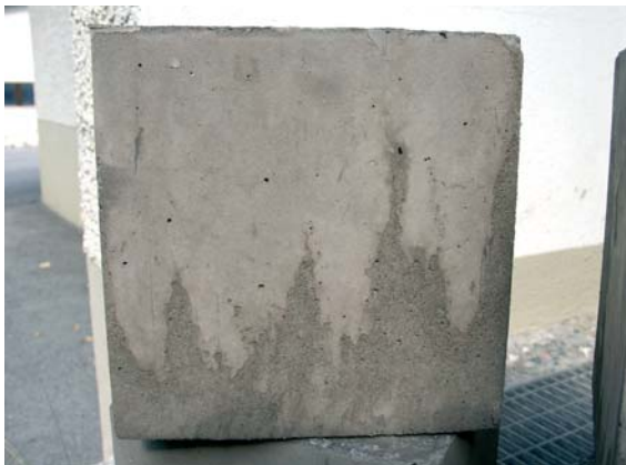
Abb. 5.6 Absandungen wegen Trennmittelüberdosierung
