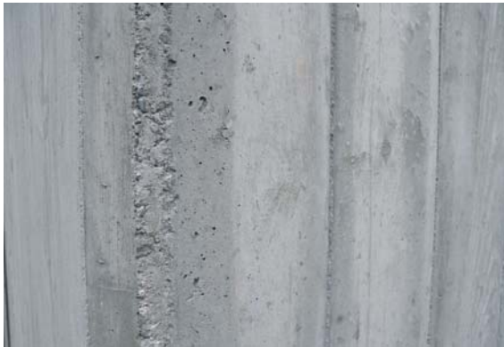
Abb. 14.4 Unsaubere Ausbildung einer gebrochenen Kante
