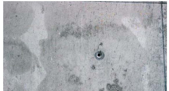
Abb. 10.2 Ablösen der Zementhaut an der Oberfläche wegen zu früh geöffneter Schalung
