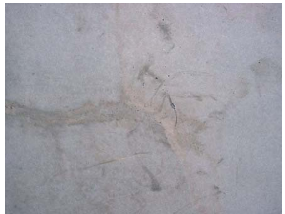
Abb. 14.15 Verfärbungen wegen zu hoher Trennmitteldosierung
