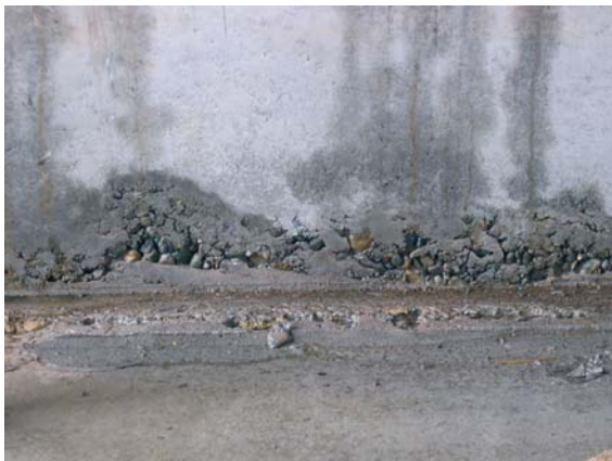
Abb. 6.15 Kiesnest am Schalungsfuß wegen undichter Schalung
