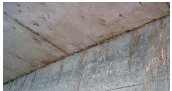
Abb. 10.4 Verfärbungen wegen zu langer Verweildauer in der Schalung
