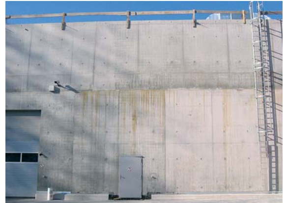
Abb. 12.7 Rostwasserspuren ungeschützter Anschlussbewehrung
