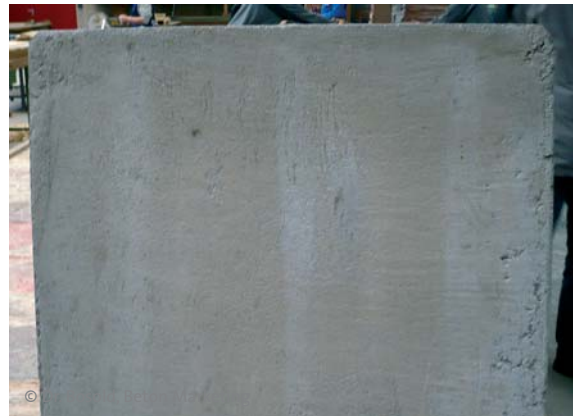
Abb. 15.6 Dieselbe, mit Rostentferner behandelte Fläche
