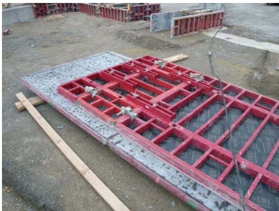
Abb. 6.1 Falsche Lagerung der Schalung: Die untenliegende Schalung trocknet stellenweise aus, was sich an der Betonwand zeigen wird
