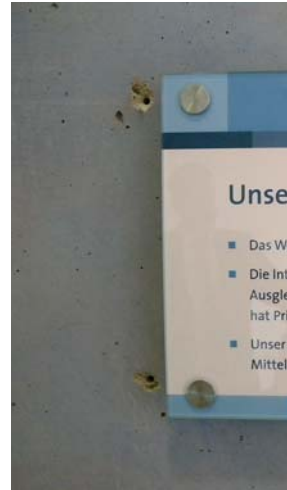
Abb. 12.3 Falsch gebohrte Löcher stören die Sichtfläche
