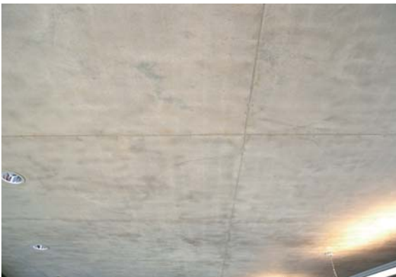
Abb. 15.10 Wegen starker Rostverschmutzungen abgeschliffene Betondecke
