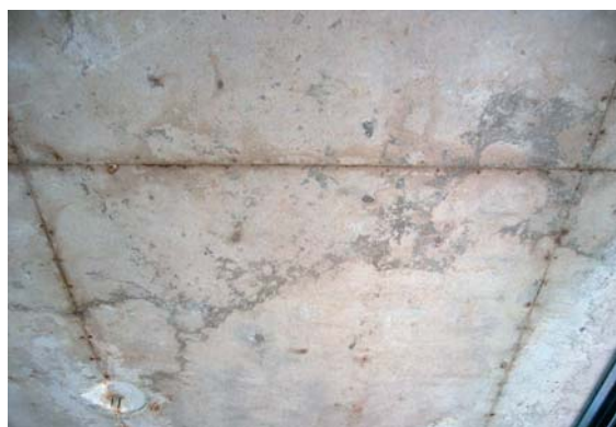
Abb. 9.7 Flecken an der Deckenunterseite als Folge zu spätem Ausschalens
