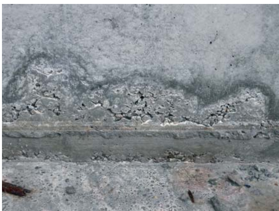
Abb. 14.9 Entmischung am Schalungsfuß
